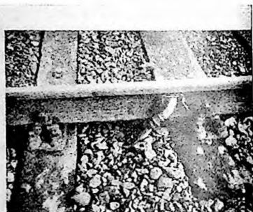
Afb. 11. Verbinding met 2-draads kabel aan spoorstaaf van batterij of relais. Nieuwe wijze van bevestiging bochtstuk aan spoorstaaf, waarbij bevestigingspunten tevens aansluitpunten zijn (geheel dubbel uitgevoerd). Rijrichting van rechts naar links, zoodat kabel speling houdt.
