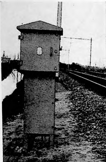
Afb. 25. Aftakkast met transformator 1500/220 V.
